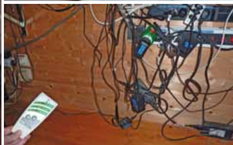
Un joli capharnaüm de câbles électriques, sous un bureau. Le champ électrique 50 Hz est à l'avenant !
