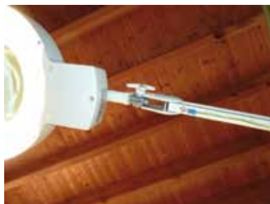
Mise à la terre du pied de la lampe de bureau, avec une cosse à œil vissée, sertie sur un fil relié à la prise de terre.
